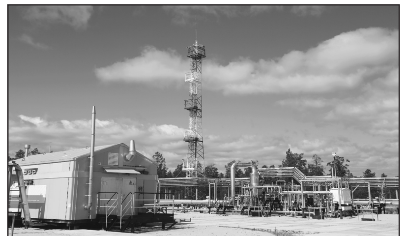
Блочная компрессорная установка.
