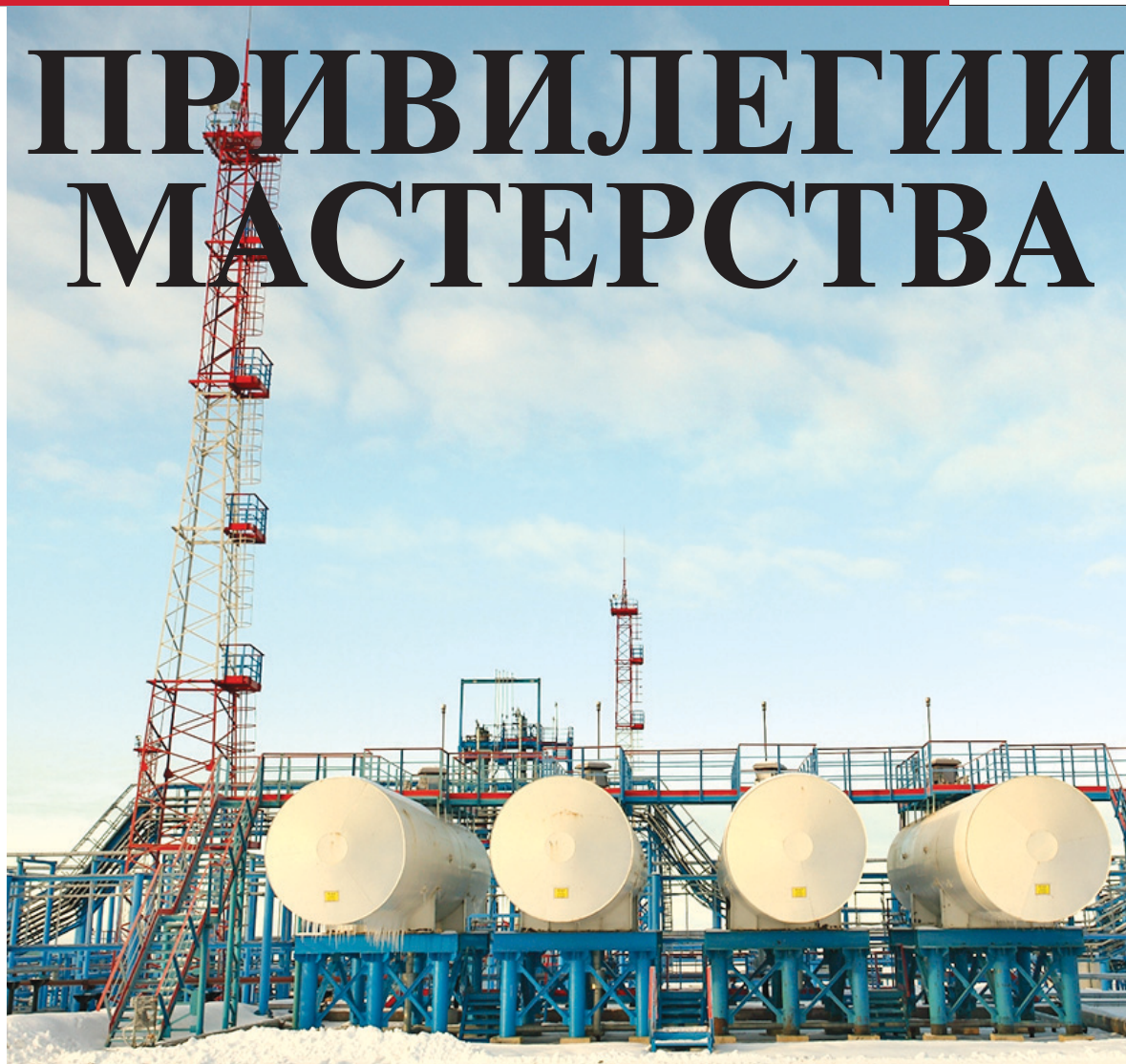
Установка комплексной подготовки газа Нижне-Квакчического месторождения.
