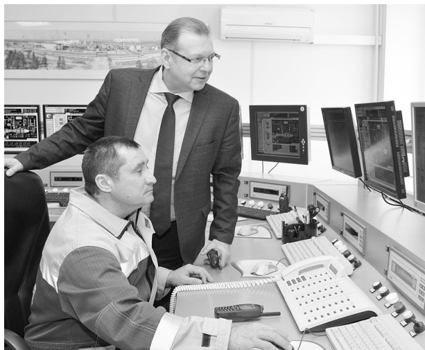
☛ Главный инженер Губкинского газового промысла Валерий Устинов и сменный инженер Алексей Тимников следят за процессами на главном щите управления ДКС. | Фото: Игорь Ружицкий, «Губкинская неделя».
